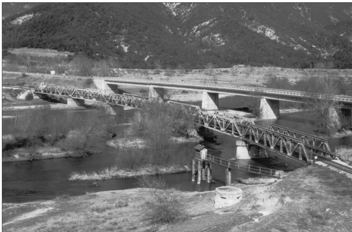
Εικ. 1. Η ΧΣΓΣ από τη νότια πλευρά της. Διακρίνονται τα ζυγώματα του 1918 (1ο, 3ο και 6ο) και του 1948 (2ο, 4ο και 5ο). Η αρίθμηση των ζευκτών γίνεται στη κατεύθυνση Θεσσαλονίκη (αριστερά) προς Αλεξανδρούπολη (δεξιά). Στο βάθος, βορειότερα, φαίνεται η σύγχρονη οδική γέφυρα από σκυρόδεμα.
