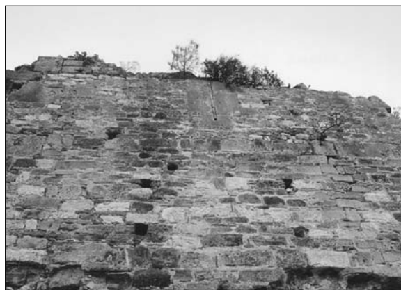
Εικ. 5. Ορθογώνιος πύργος “κεντρική ντάπια” βορεινή πλευρά με την θυρίδα τοξοβολής, στην μέση περίπου του διάμεσου τείχους (φωτογραφία Ν. Ιωαννίδου).
